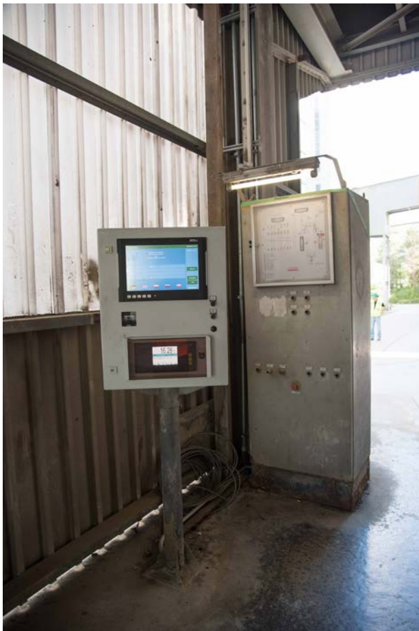
VAS loading terminal.
